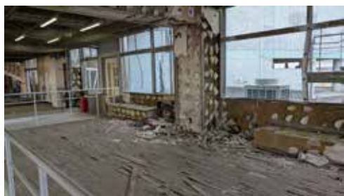
震災遺構・請戸小学校の教室跡。津波が校舎2階床近くまで襲来し、1階部分は壊滅状態だった。
